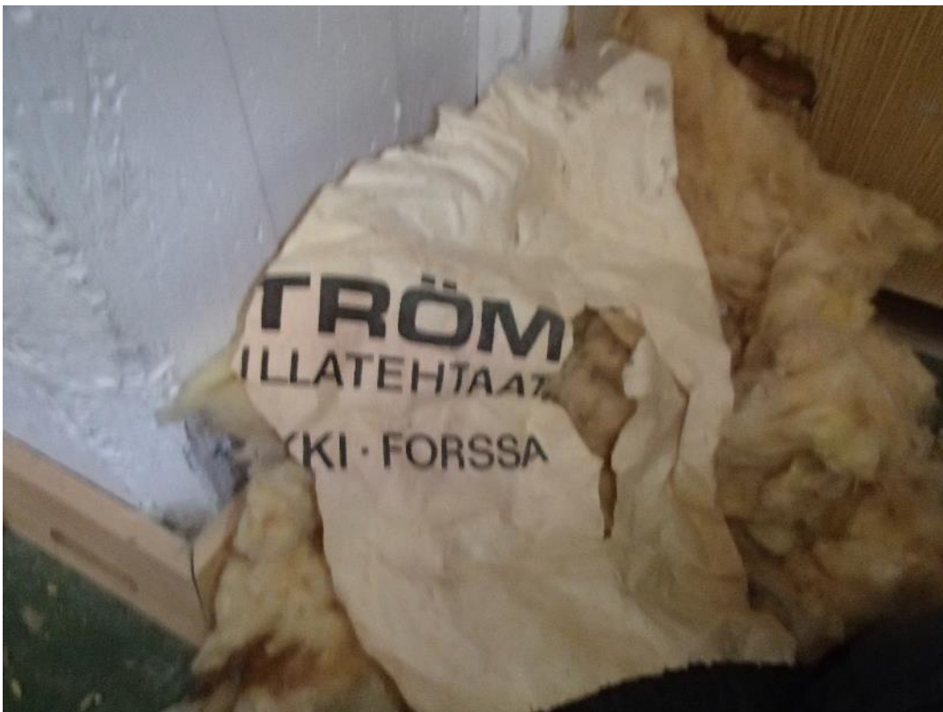
Kuva 5. Rakenneavauskohdassa, RAKL4, havaittiin eristetilassa vanhaa pakkausmateriaalia.
