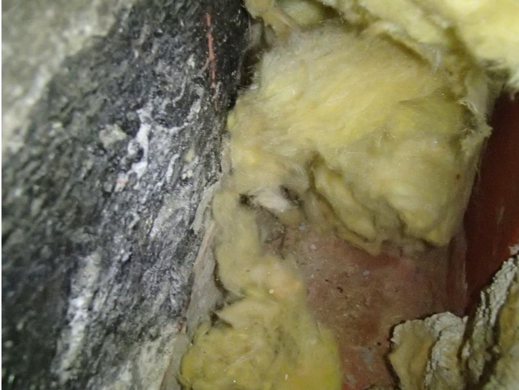
Kuva 4. Sokkelin sisäpinnassa havaittiin kalkkihärmekertymiä.
