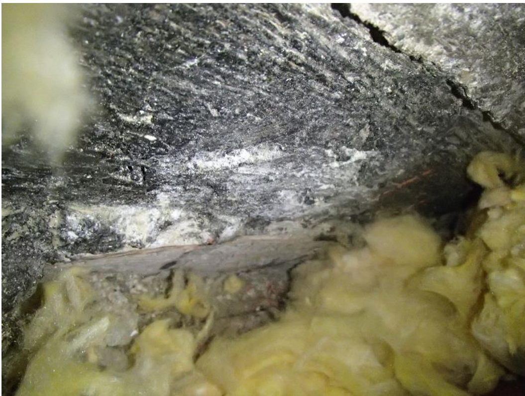
Kuva 3. Sokkelin sisäpinnassa havaittiin kalkkihärmekertymiä.
